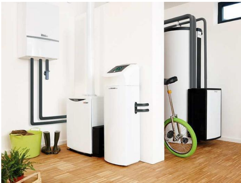
Abbildung 85: Das Mikro-BHKW als platzsparendes Kraftwerk (Quelle: Freie Presse)
